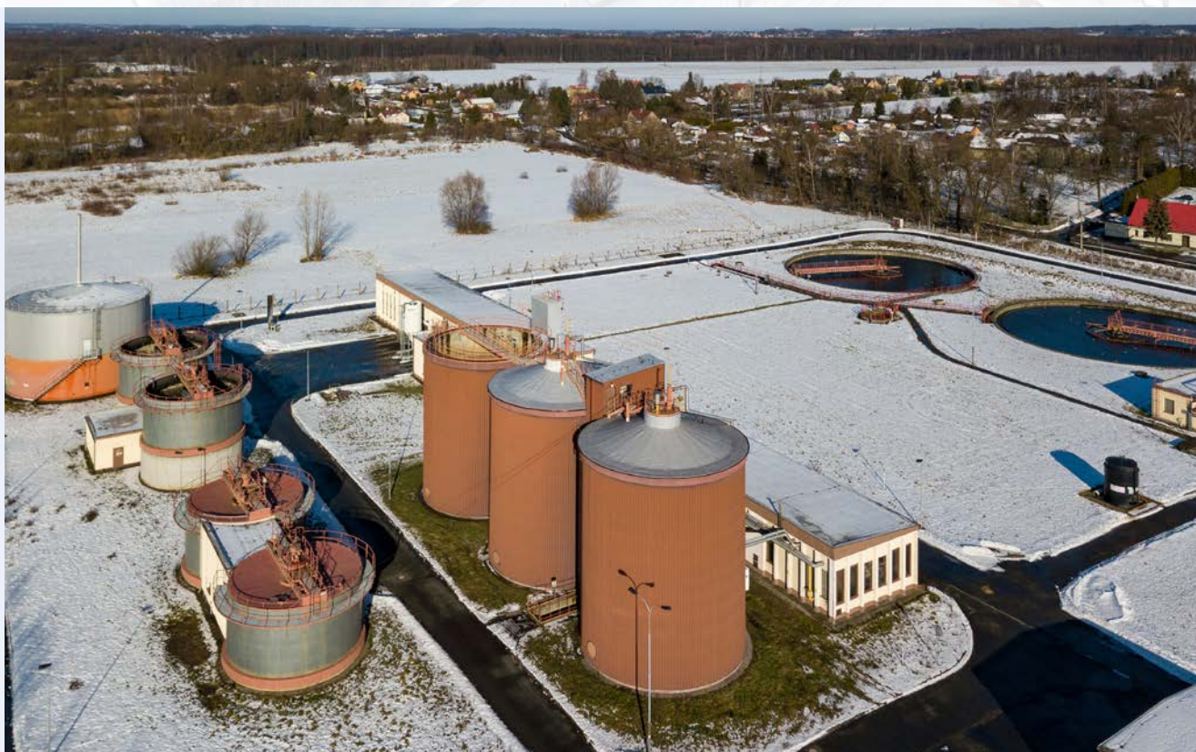
Čistírna odpadních vod Karviná – Dokáže vyčistit odpadní vodu pro téměř 90 tisíc ekvivalentních obyvatel. Denně dokáže zpracovat až 30 tisíc metrů krychlových odpadních vod.
